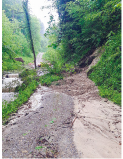
Widenbachstrasse nach Unwetter
