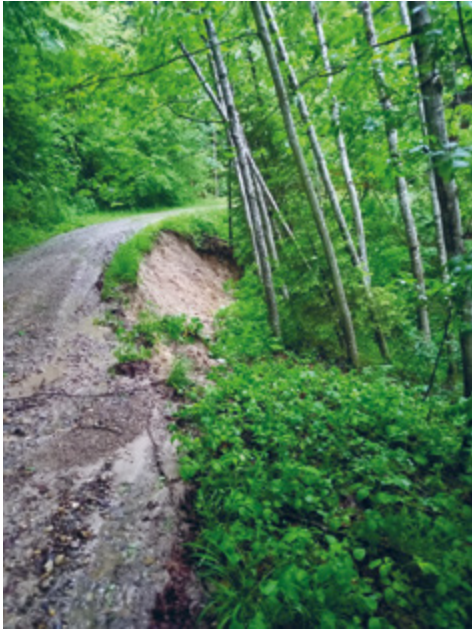
Rutschung Erschliessungsstrasse Reggtal
